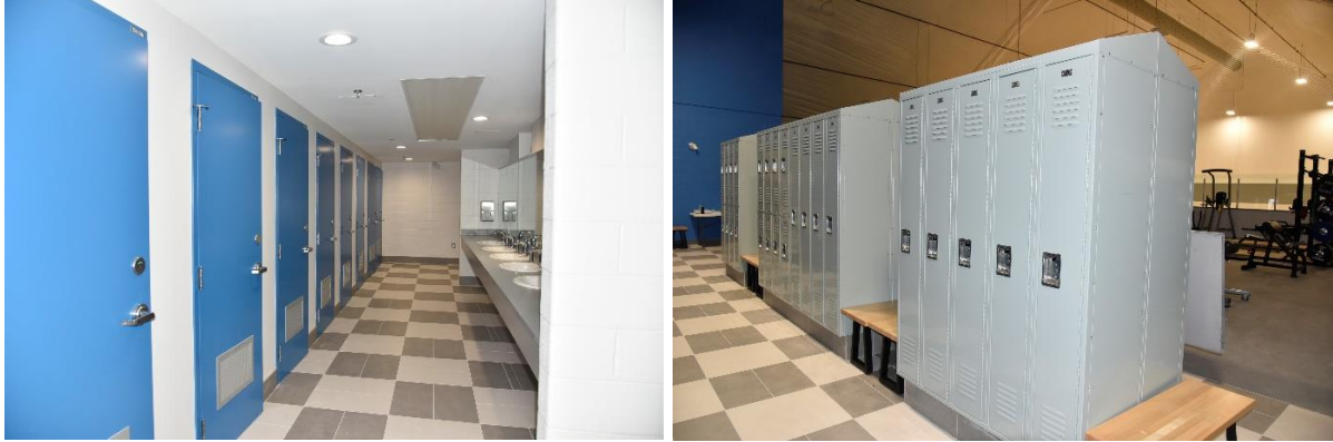
Des douches/toilettes universelles à aire ouverte et des casiers de jour ont été installés à l'intérieur de l'établissement et sont prêts à être utilisés.
